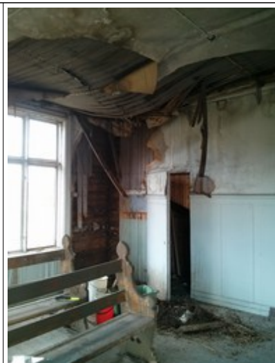
Vattenskada i kyrksalen
