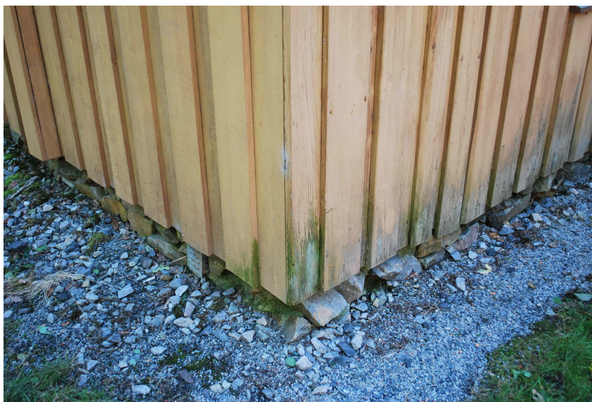
Skader ved takdrypp. Langvegg med takdrypp til høyre
