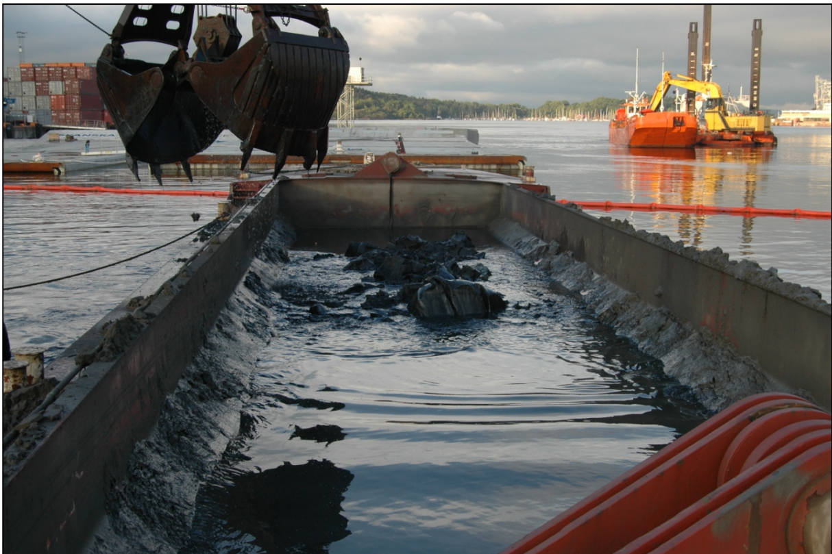
Figur 10. Parallelt arbeid mellom i Senketunnelprosjektet og prosjekt Ren Oslofjord . Nærmest mudres det rene masser i senketunneltraseen, og bak til høyre mudres det forurenset sediment i prosjekt Ren Oslofjord . Bispevika 28.08.2006.
