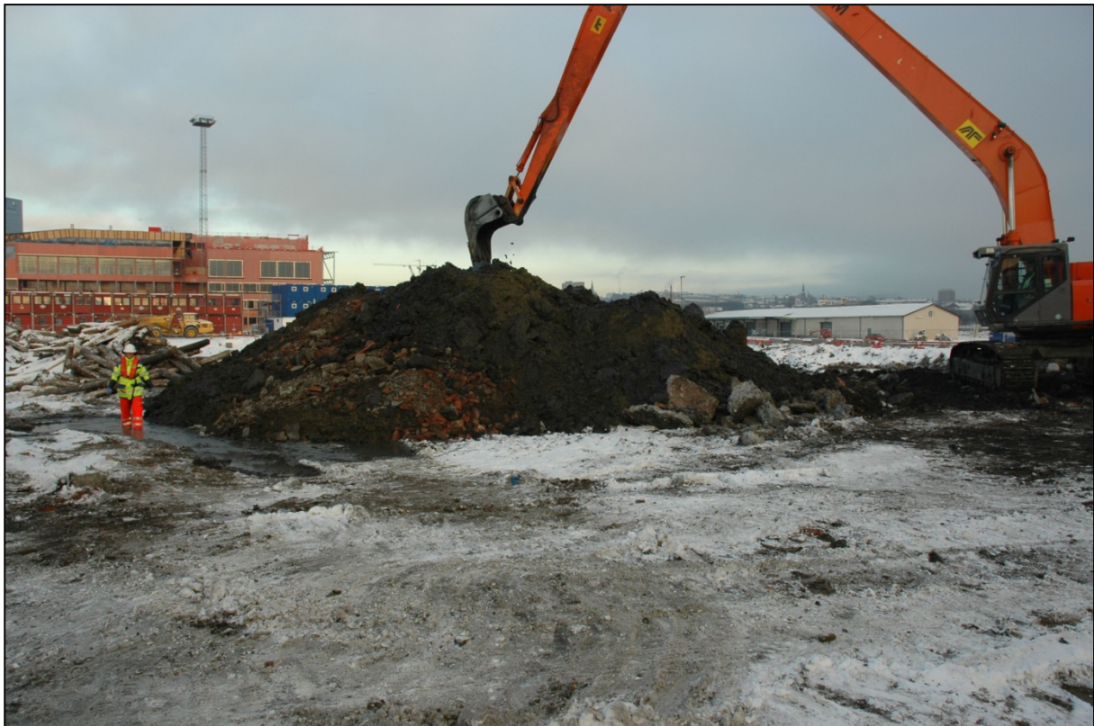
Figur 20. Masser legges i ranker på Bjørvikautstikkeren 2. Februar 2006. Gravingen foregår med maskin med grabb som har ekstra lang rekkevidde.
