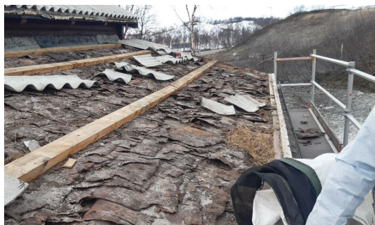
På Sørelva måtte undertaket av eternitt fjernes. (Foto fra Rognan Byggsenter AS)
