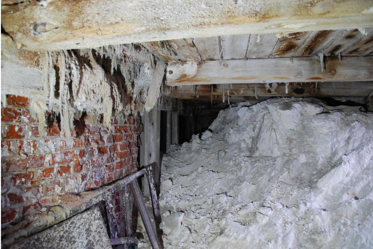
Figur 43: Luthuskjelleren. Spill av mesakalk fra oven ligger i en stor dunge, vegger og tregolvet over er sterk skadet av salt.
