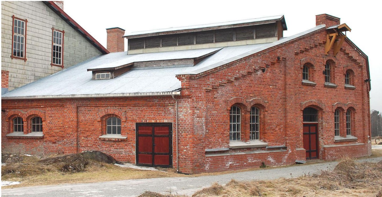
Figur 15: Sodahusets nordvegg og østvegg. Dette er deler av fabrikken der teglveggene stikker under terrenget og således er sterkt påvirket av fukt og salt, spesielt innvendig. Fundamentene er dels av stein, tegl og betong, noe som reflekterer utbedringsarbeider. Vi ser (til venstre) hvordan berg i dagen stikker opp, noe som viser hvor grunt bygningen ligger mot fjellet. I denne sonen er det ikke kontroll på overvann og drenering. Herfra kommer det svært mye fukt inn i fabrikken.
