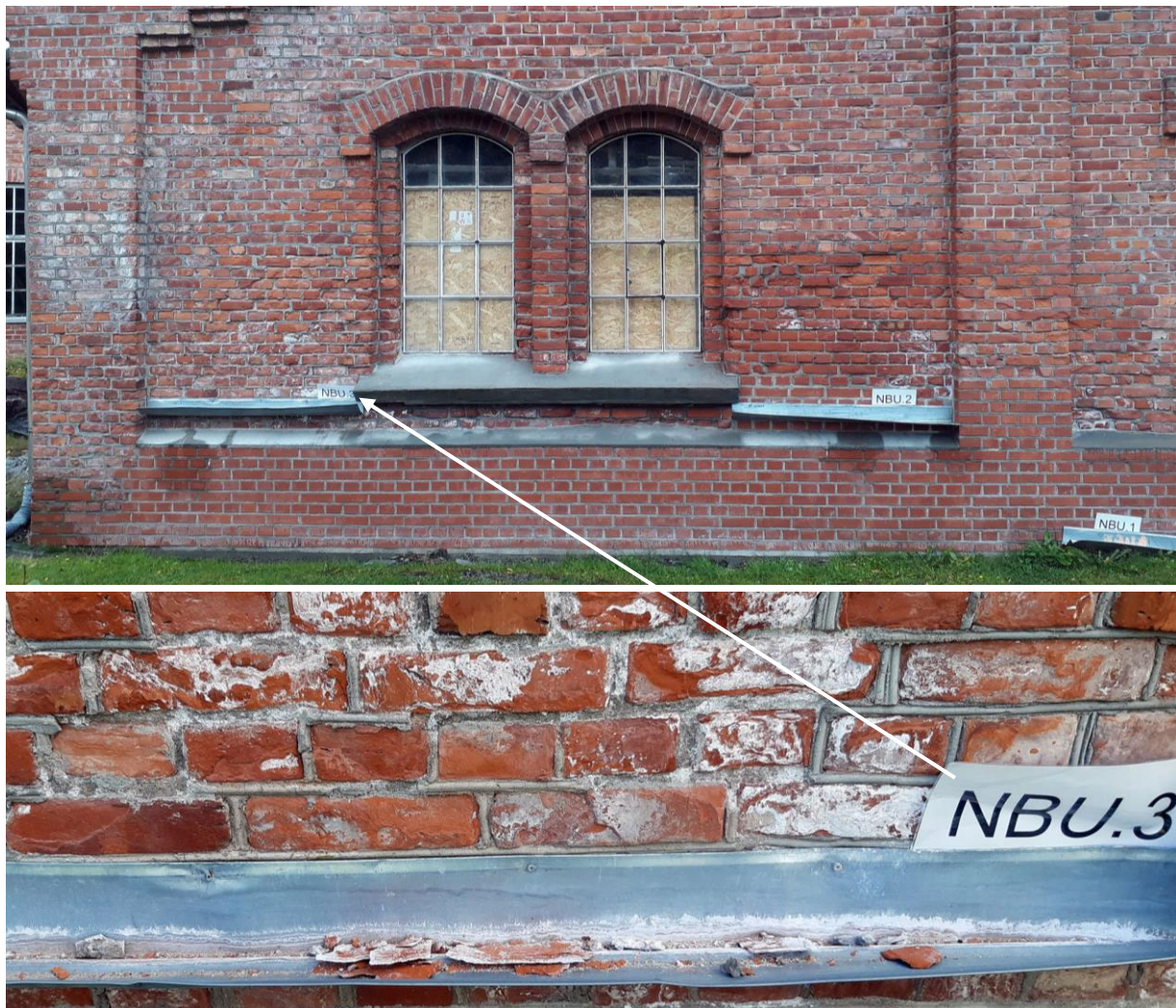
Figur 90: Testfeltene på nordsiden av Sodahuset, med oppsamlingsbrett for nedfalt materiale samlet opp og veid på månedsbasis. En kan se at fukten stiger 2-3 m opp på veggen. Det nederste bildet (foto: M. Wantola) viser nedfallet i NBU3 samlet opp etter juni 2021. Med salt på «baksiden» av teglfragmentene er det åpenbart at saltforvitring er årsaken. Saltene er først og fremst natriumsulfater.
