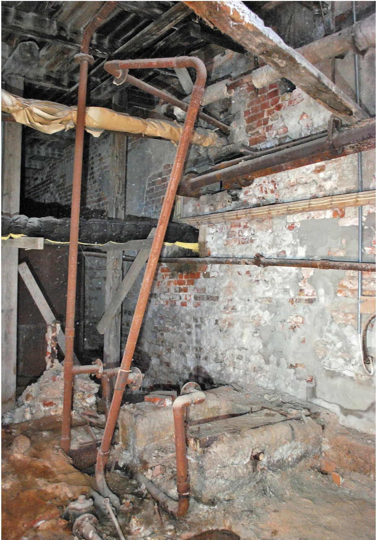
Figur 70: Luthuskjelleren. Fra tanker i kjelleren ble den ferdige hvitluta pumpet i rør til Kokeriet. Det er de rustne rørene på bildet det dreier seg om. Legg også merke til de fuktige forholdene med sterk saltforvitring på golvet og veggene.
