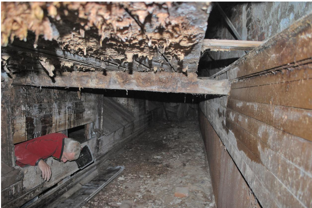
Figur 56: Massetroa i Kokeriet. Til denne forede troa ble cellulosemassen tappet ut fra kokerne og senere manuelt videreført til Silhuset – fra den bakre enden av troa (sett fra fotografens ståsted).
