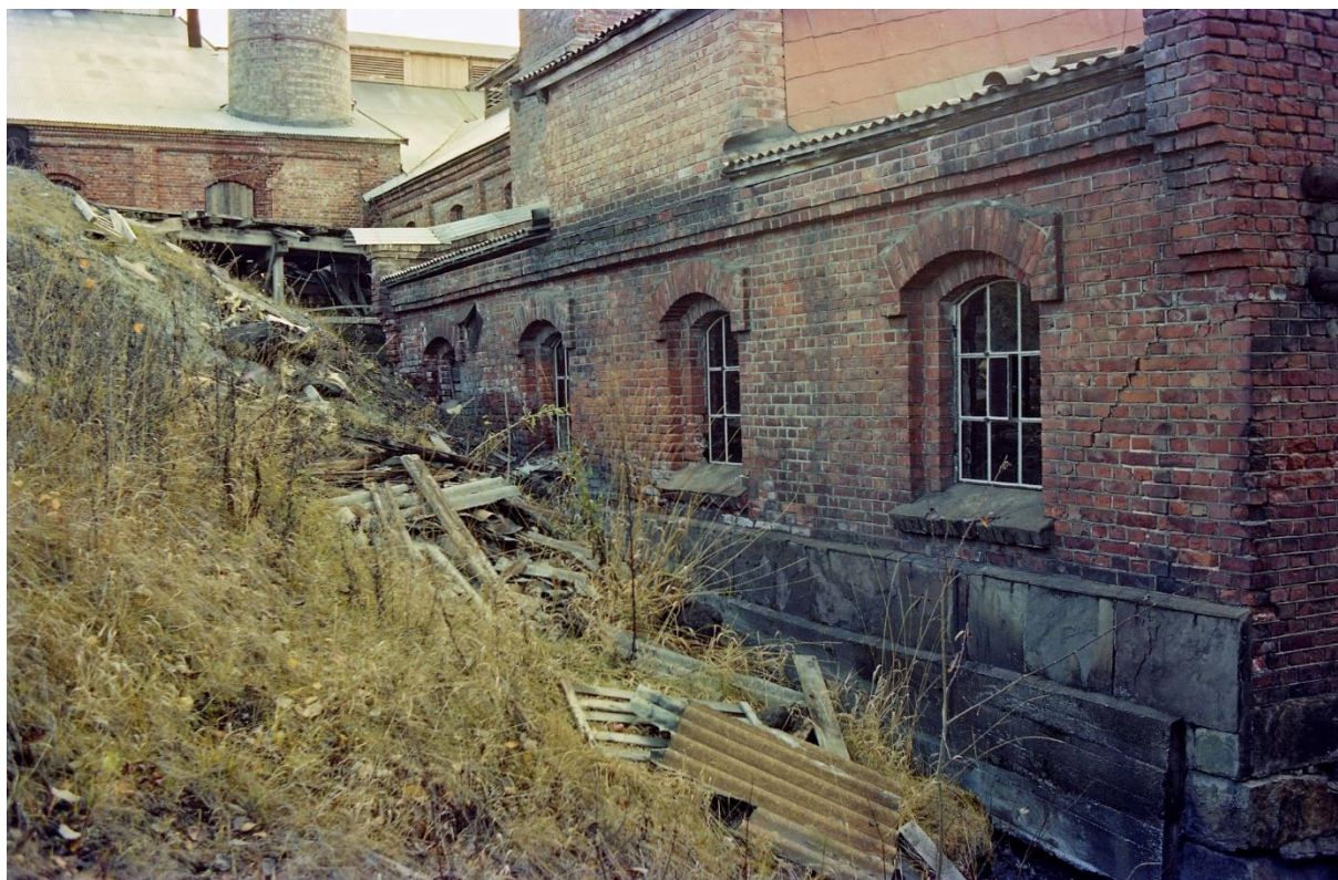
Figur 38: Sorte avsetninger på Luthusets nordvegg ca. 1989. De er mindre utbredt i dag, som følge av regnvasking og trolig restaureringsarbeid. Avsetningene er ikke analysert, men det kan dreie seg om sorte gipsskorper, dannet ved hjelp av luftforurensning. Foto: Anno Museum.
