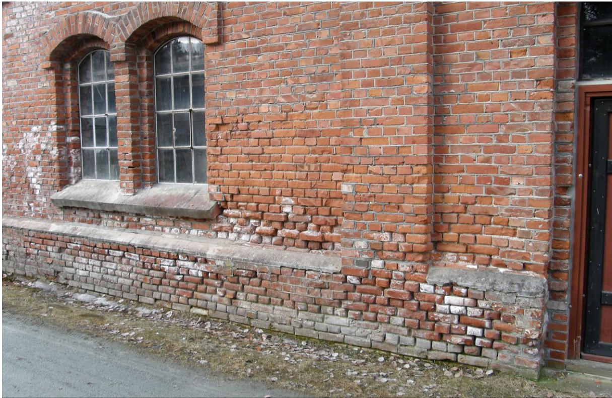
Figur 23: Nordveggen til Sodahuset i 2012. Ca. 30 år er gått sidene istandsettingsarbeidene tidlig på 1980-tallet. Vi ser betydelig forvitring og at teglveggene stikker ned i bakken. Foto: Anno Museum.
