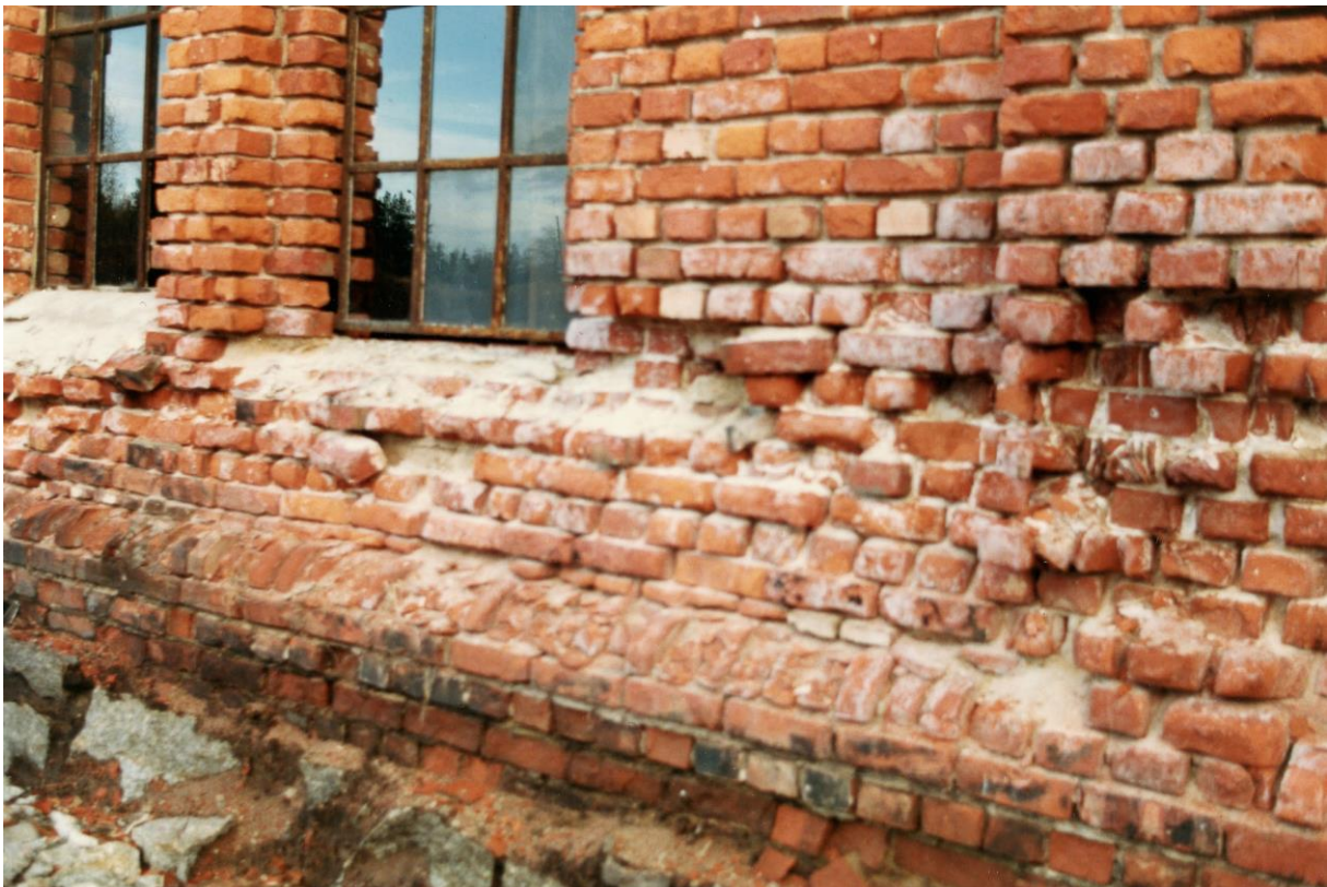
Figur 22: Søndre deler av Sodahusets vestvegg, ca. 1989, som ikke ble satt i stand før 1984 (jfr. bildet over). Store skader i teglmurverket. I etterkant er reparasjoner utført. Foto: Anno Museum
