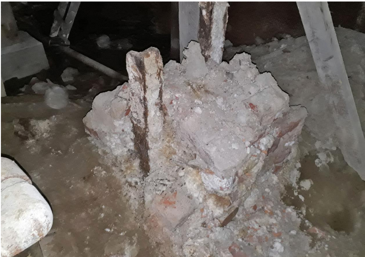
Figur 44: Søylefundament i kjelleren i Luthuset er helt oppspist av salt. Legg også merke til rustende jern, påvirket også av sulfatet i grunnen. Selv om det også er sterkt basiske salter her, så gir de tilsynelatende ingen «korrosjonsbeskyttelse» når det også er mye sulfat.
