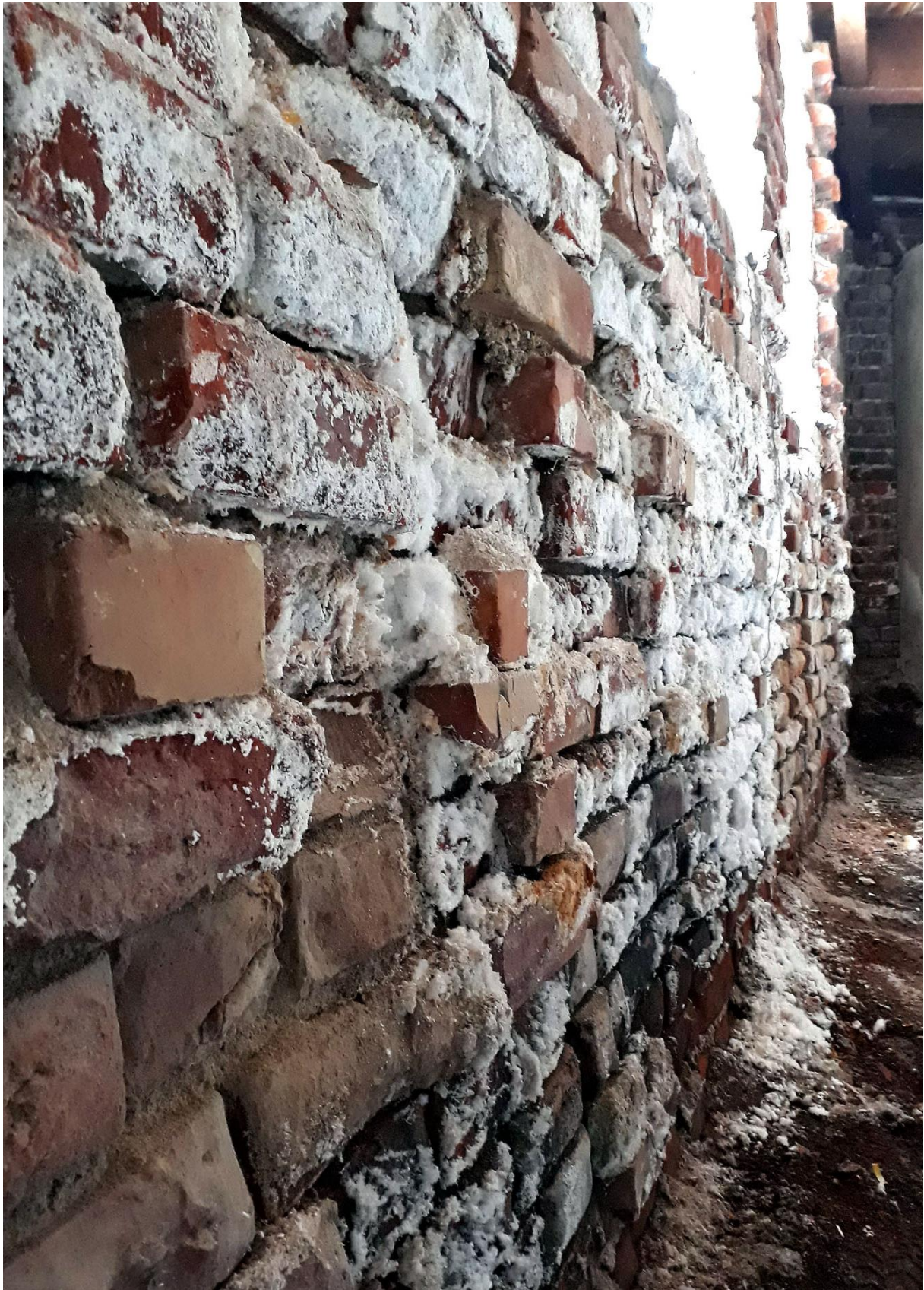
Figur 42: Sodahusets nordvegg, østre del. Sterkt saltskadd vegg, hovedsakelig natriumsulfater. Her er det nå satt opp forsøksfelter for saltforvitring, se senere i rapporten. Sammenlign også med fotos fra utsiden og arbeider som ble gjort for å styrke vegg og bedre fuktforhold i 2012 (Figur 23, Figur 24). Som en kan forstå har ikke arbeidene hjulpet mye. Sammenlign også med fundamentkart, Figur 12.
