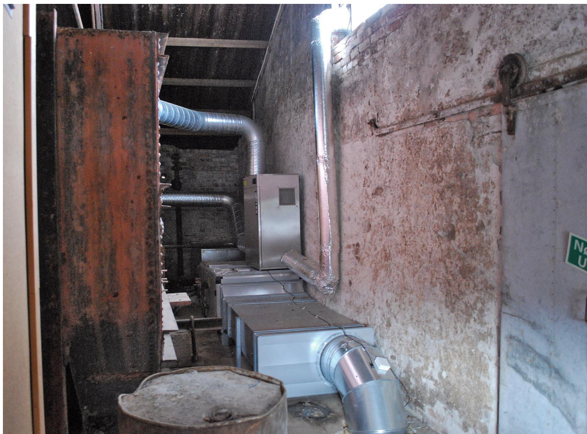
Figur 79: Dagens klimaanlegg for Hollenderiet er plassert på det såkalte limloftet. Her får man et inntrykk av de nokså begrensede dimensjoner det dreier seg om.
