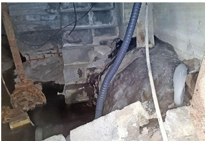
Figur 11: Fra området omkring den såkalte grønnluttanken, sprengt ut under den nordlige delen av Sodahuset. Her ser vi hvordan vann strømmer ut fra en fjellsprekk, med betongvegger over. Vannet er frosset, bildet ble tatt under den strenge vinteren i januar 2021.
