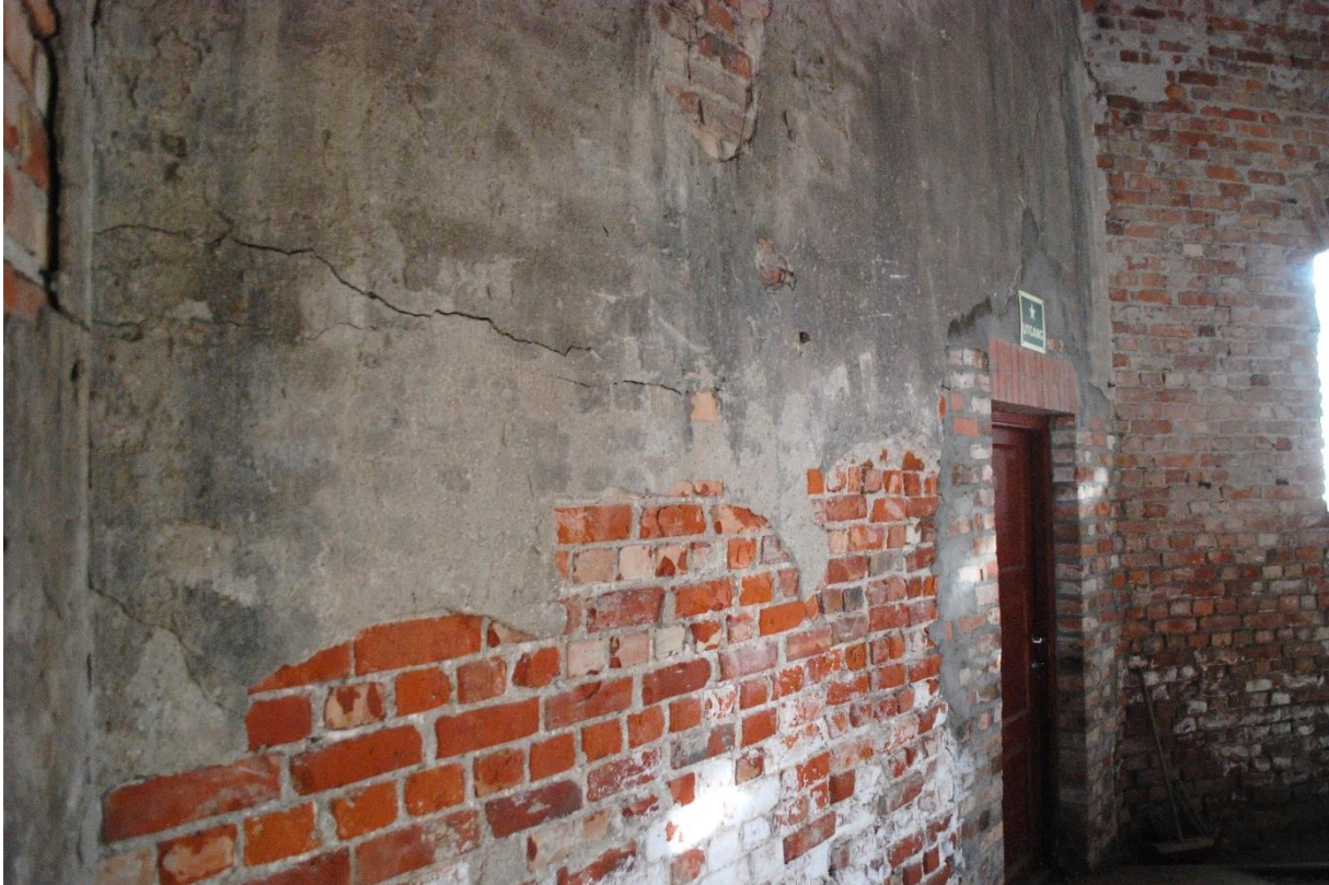
Figur 75: Rester av opprinnelig puss i det nordvestre hjørnet av Sodahuset. Det dreier seg om en enkel puss på kalkbasis, men mulig med en liten sementtilsetning. Pussen er godt bevart der det ikke er mye salt.
