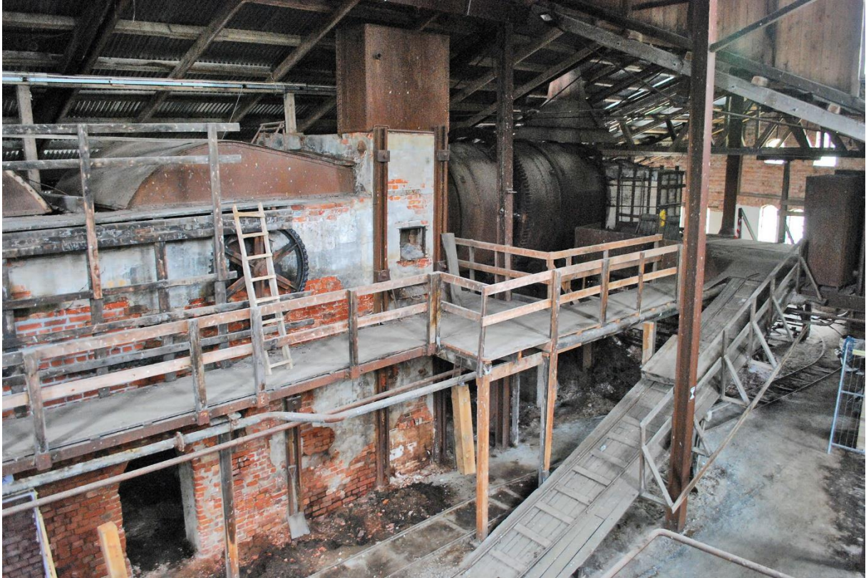
Figur 59: Nordre del av varpa, roterovn og sodaovn bakerst i bildet. Legg merke til skadene på den nedre delen av varpa og hvor mye som har falt ned.
