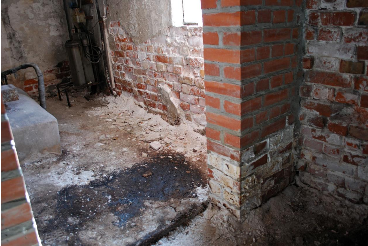
Figur 40: Sodahusets vestvegg, ved lite motorhus. Betydelig saltforvitring og mye skadd mur er falt ned.
