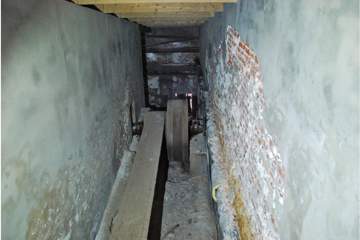
Figur 45: Remkanalen mellom Luthuset (høyre) og Kokeriet (venstre) er reparert med sementpuss for å «styrke» konstruksjonene. Som vi ser går ikke dette særlig bra når det er så mye salt tilstede.
