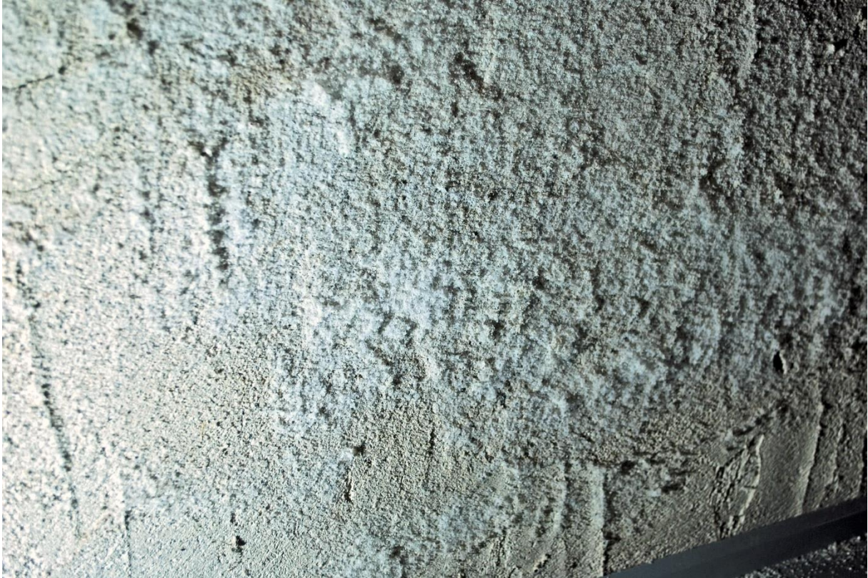
Figur 106: Hovedtestfelt på nordveggen i Sodahuset, ikke-klimatisert: Her ser vi at offerpussen tar opp salt og gir krystallisasjon på overflaten. Bilde fra september 2021.
