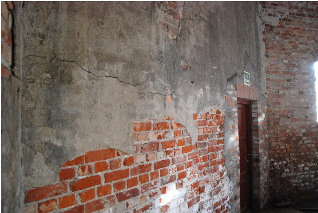
Figur 16: Sodahusets nordvestvegg innvendig. Nær alle deler av fabrikken var innvendig opprinnelig pusset med enkle, relativt tradisjonelle kalkmørtler (dvs. mørtler med lite sement). Pussen var også hvittet. På grunn av den intense forvitringen har de aller fleste pussmørtlene gått tapt, spesielt i de nedre deler av murverket. Bildet viser et av de større feltene som fortsatt er bevart
