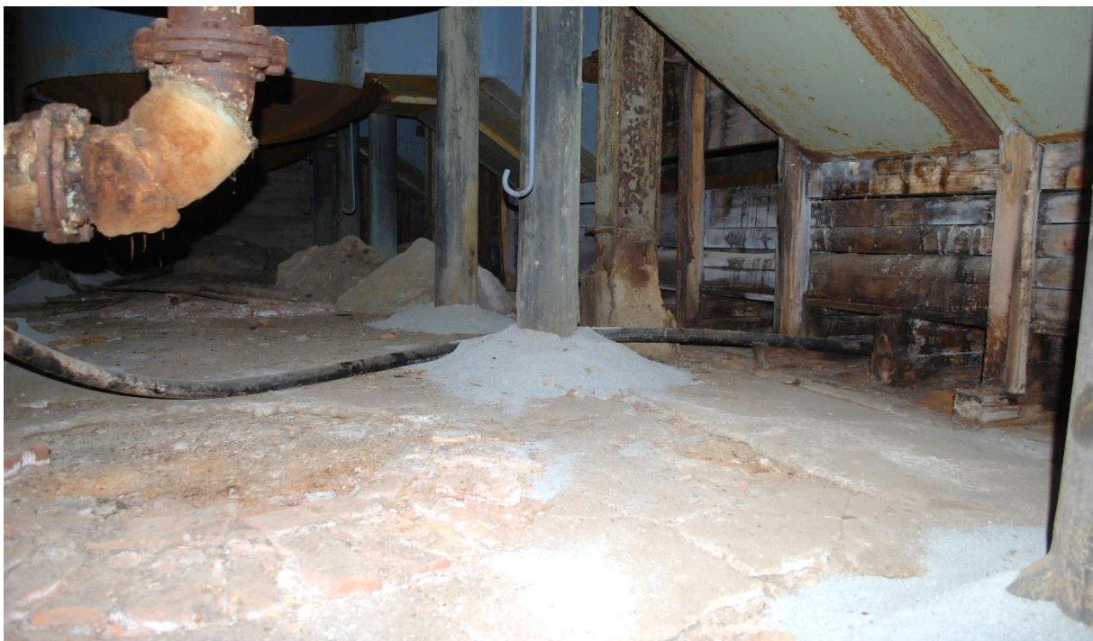
Figur 115: Testfelt med subbus over søylefundamenter i kokerikjelleren, etablert sommer/høst 2020. Disse har hindret større saltutblomstringer og skader på fundamentene, men er foreløpig å anse som et midlertidig tiltak i påvente av reduksjon av grunnfukt og reparasjon av fundamentene.
