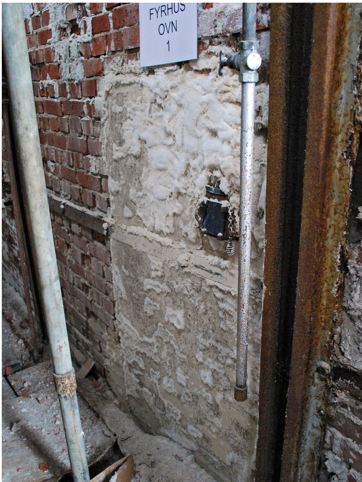
Figur 109: Fyrhuset – murverket omkring fyrkjelen, vestre side. Offerpuss med Keim Porosan HF som har fungert utmerket og tatt opp store mengder salt mellom august 2020 og høsten 2021. Her er det lett å børste eller støvsuge vekk saltet for å redusere mengdene salt i murverket på sikt. En skal være oppmerksom på at fukt- og saltforholdene nå er dramatiske i denne delen av bygningen og at en ikke uten videre kan sammenligne de store saltmengdene på pussmørtelen med andre offerpusser vist på bilder i denne rapporten.
