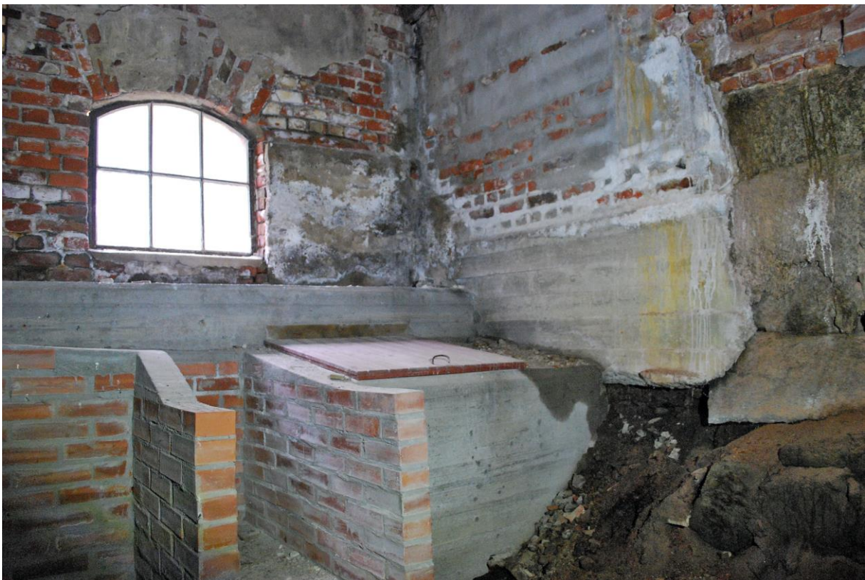
Figur 74: I det nordøstre hjørnet av Fyrhuset er det utført betydelige, nyere sikringsarbeider med betong. Mye fukt siver inn her. Sist gang det var overvann på golvene i Fyrhuset var i 2020.
