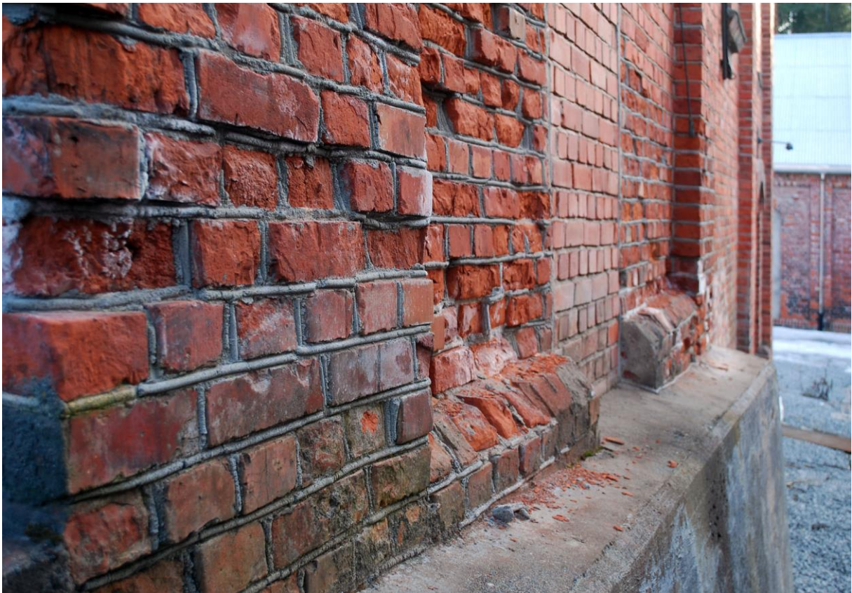
Figur 51: Forvitring på Fyrhusets NV-hjørne. Salt er viktig her, men frost og tette sementfuger (KC 35/65) bidrar også. Dessuten blir fukten og saltet tvunget høyt opp i veggen av en betydelig påstøp med tett betong (nederst i bildet). Videre gir takdrypp på hjørnet ekstra fuktbelastning. Legg for øvrig merke til at teglsteinene har ulik grad av forvitring. Dette skyldes vekslende tegl kvalitet, spesielt knyttet til porøsitet og porestruktur.
