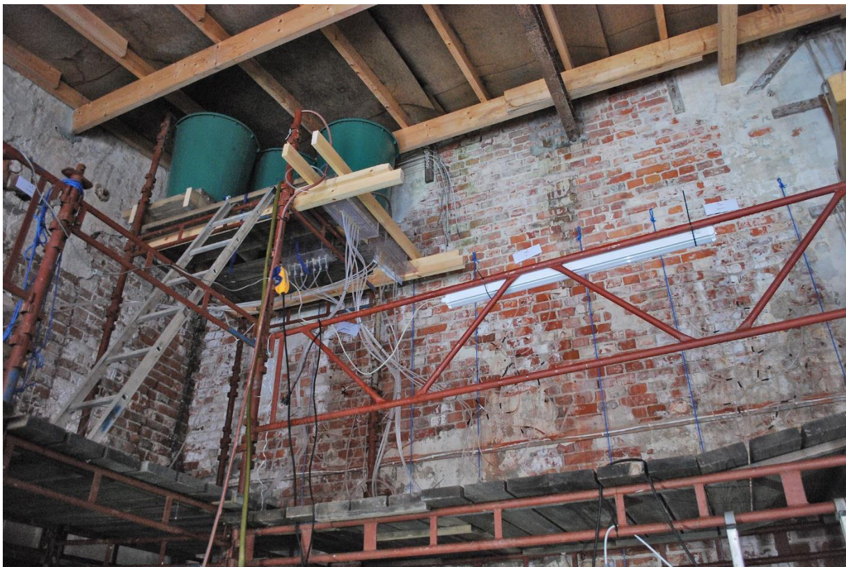
Figur 76: Forsøksfeltene for saltkonvertering i Motorhuset med sine forvitrede vegger. Det er veggene mot Luthuset som er sterkest skadd. Legg merke til de store fatene med kloridløsning for injisering via slanger til borte hull i teglstein. Forsøksoppsettet er nå fjernet.
