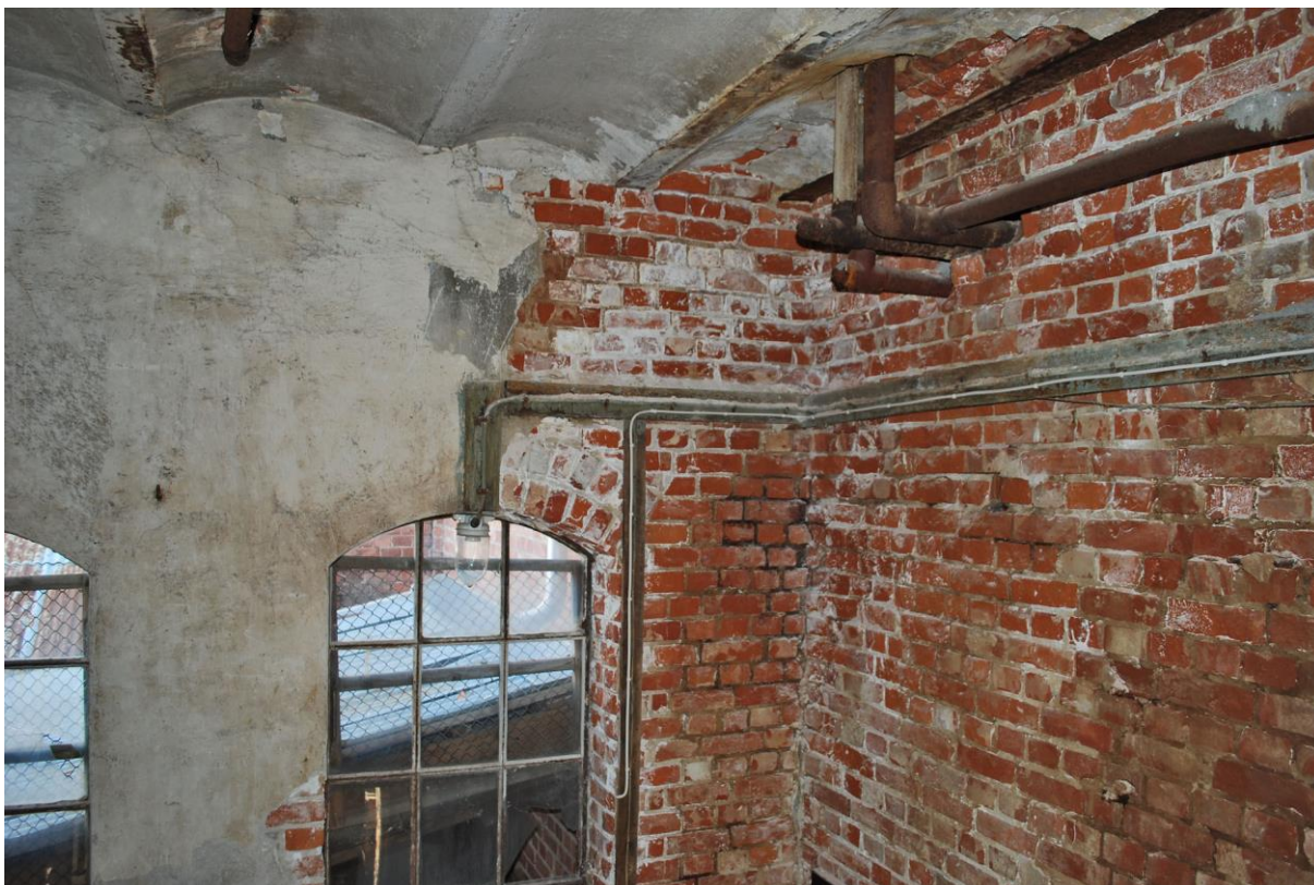
Figur 58: Lut ble pumpet i rør mellom Kokeriet og lutgjenningsanlegget. Det har ennå ikke lyktes å identifisere hensikten med alt røropplegg i fabrikk. Her er vi i det nordøstre hjørnet av Kokeriet, i overgangen mot Remkanalen og Luthuset/Mikseriet. Rørene høyt oppe kan ha hatt lekkasjer og bidratt til den sterke saltforvitringen i dette hjørnet. Men vannlekkasjer kan også ha spilt en rolle.
