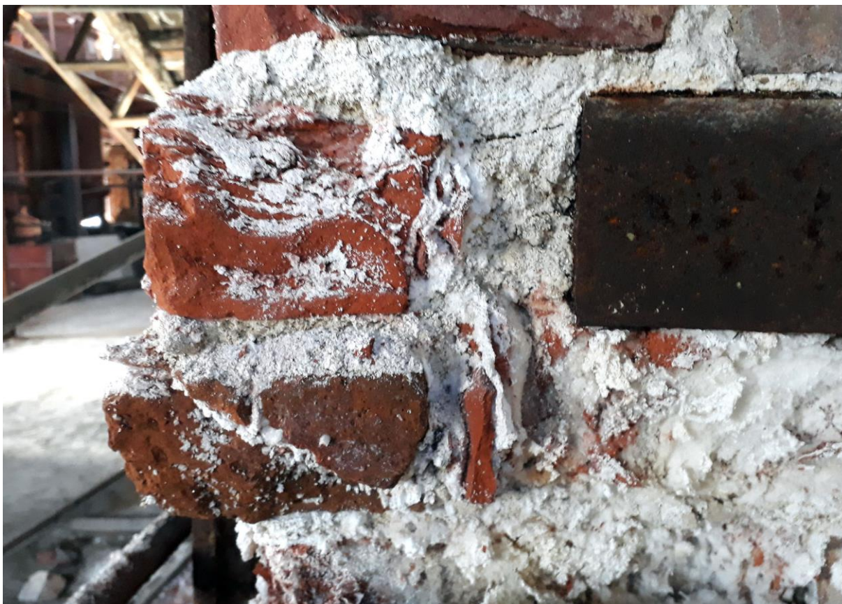
Figur 28: Ekstrem saltforvitring på den østre sodaovnen. Vi kan se at krystallisasjon av store mengder salt har hatt kraft nok til å forskyve hele teglsteiner, og det i et murverk som har betydelig tyngde ovenfra.
