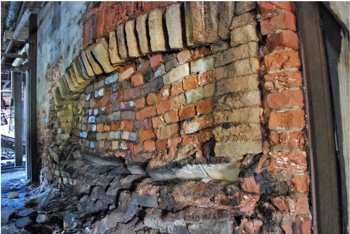
Figur 60: Nordveggen til varpa er preget av sterk saltforvitring og mye søl av svartlut fra oven. Det kan se ut til at forvitringen er en hovedårsak til de betydelige deformasjonene i murverket.
