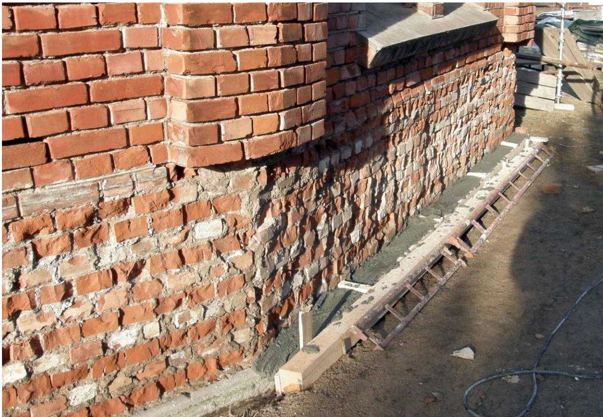
Figur 24: Utbedringsarbeider på nordveggen til Sodahuset i 2012. Sokkelen/fundamentet er «sikret» med et betongskall og veggene er meislet i påvente av oppføring av et ytre lag med ny teglstein satt i sterk sement. I dag vet vi at denne arbeidsmåten tvinger salt opp i veggene. Foto: Anno Museum.
