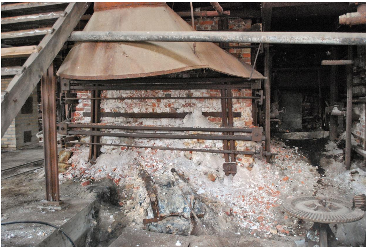
Figur 2: Den ene av to sodaovner for å smelte kokelut for gjenvinning viser det mest ekstreme utslaget av saltforvitring . Flere titalls kilo salt og fragmenter av forvitret teglstein er ramlet ned. Flere steder er det omtrent like ille, men de fleste deler av fabrikk er på langt nær så skadet.
