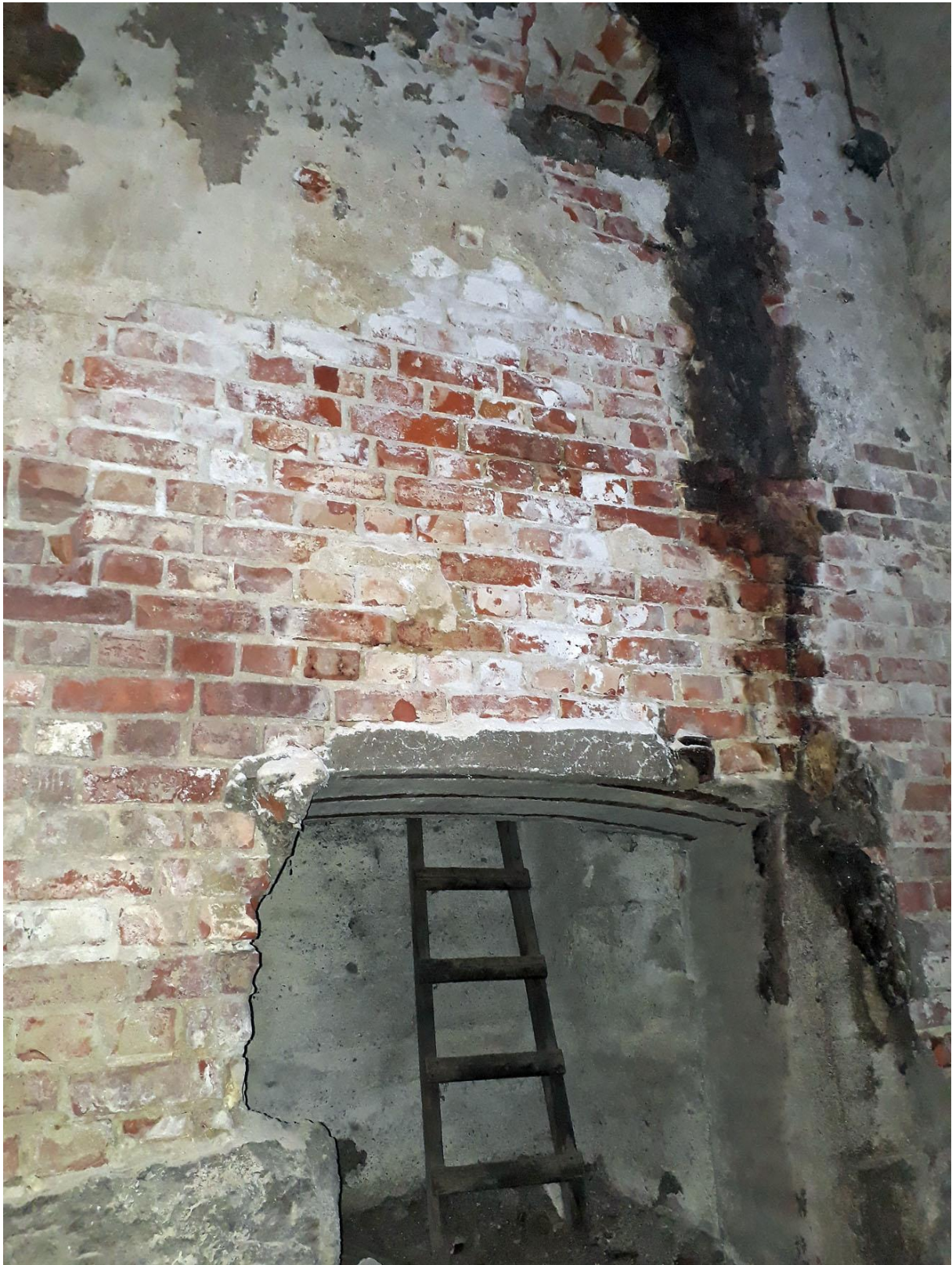
Figur 49: Nordveggen i underetasjen i Hollenderiet (Turbinhallen) med inngang til kjelleren i det gamle Hoggeriet. Her er det også betydelig saltforvitring, men en har ennå ikke helt forståelse for de mer nøyaktige kildene til saltet og fukten som mobiliserer det.
