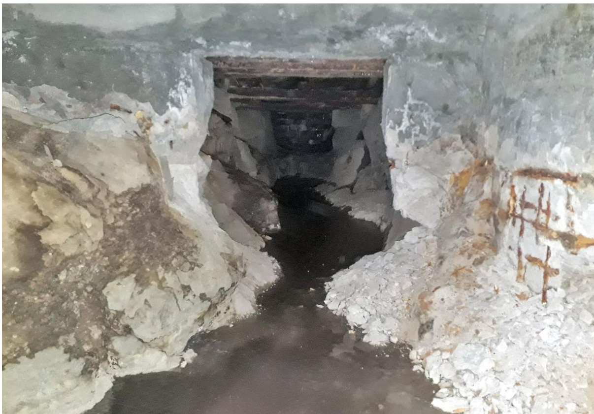
Figur 72: Utsprengt kanal med sulfatholdig vann fra det utsprengte området for grønnluttanken under sodaovnene. Legg merke til betong med armeringskorrosjon. Kanalen fortsetter i dårlige funksjonerende rør utenfor fundamentene/veggene.
