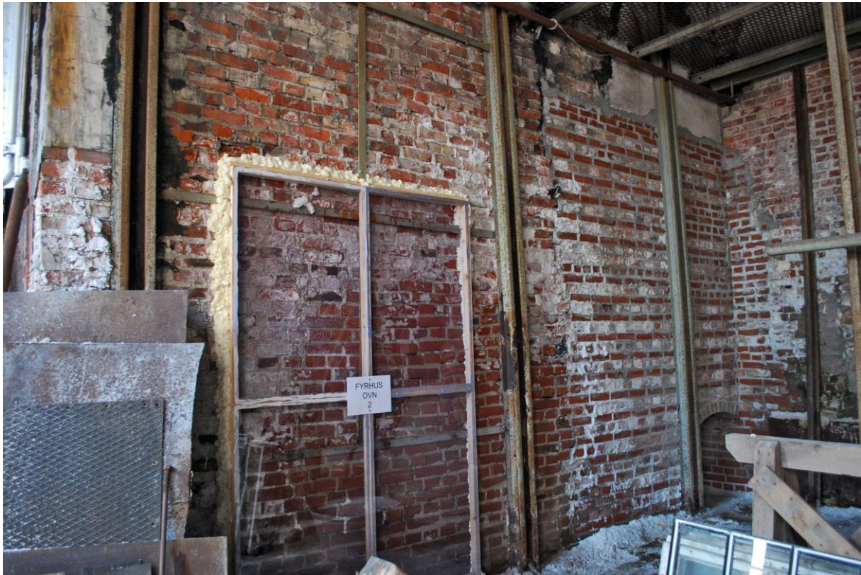
Figur 114: Plexiglassfeltet på østsiden av murverket som omslutter fyrkjelen i Fyrhuset. Bildet er tatt sommeren 2021, under relativt tørre klimaforhold. Vi ser at det er en nær sirkulær «kjerne» av høy fuktighet på murverket, som hindrer salt i å krystallisere. Men vi ser også at i de øvre og venstre deler av murverket, så er det tørt nok til mye krystallisasjon. Men alt i alt så har plexiglasset hindret krystallisasjon av salt, på lik måte som på sodaovnen (se over).
