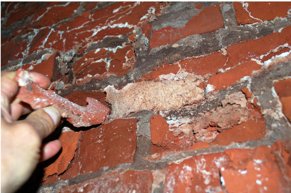
Figur 41: Varpa i Sodahuset er sterkt skadet. Selv om det ikke alltid er så lett å se saltmengder på linje med grunnfuktsonen langs vegger, så er salt alltid tilstede, ikke minst under flak og i sprekker og riss. At salt er litt mindre synlig, kan være fordi saltet trona er viktig her. Trona er mindre løselig i vann enn natron/thermonatritt og kan forbli relativt stabil om det ikke er så mye fukt tilstede. Varpa er imidlertid preget av kondenshendelser, som vi senere skal se.
