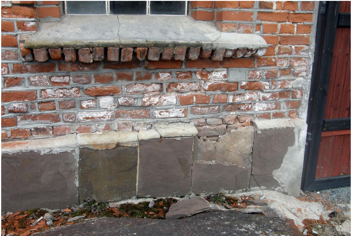
Figur 25: På den østre siden av Sodahuset var det tidligere satt opp skiferplater for å hindre vann i å trenge inn langs murene. Dette hadde kun den virkning at grunnfukten ble tvunget høyere opp i murene. Her bilde fra 2012. Platene er nå fjernet. Foto: Anno Museum.
