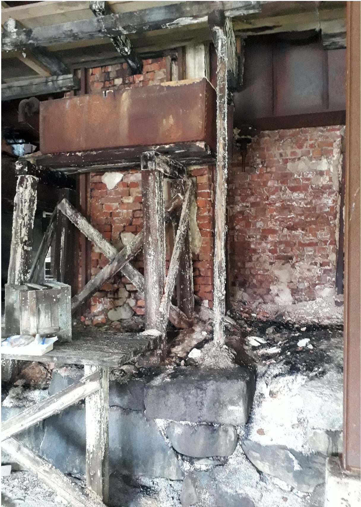
Figur 61: Overgangen mellom varpa og roterovnen sett fra vest. I dette området har det forekommet mye spill. Legg også merke til granittfundamentene og skadene på teglmurverket. Jfr. Figur 60, som viser forholdene rett rundt hjørnet i venstre billedkant.
