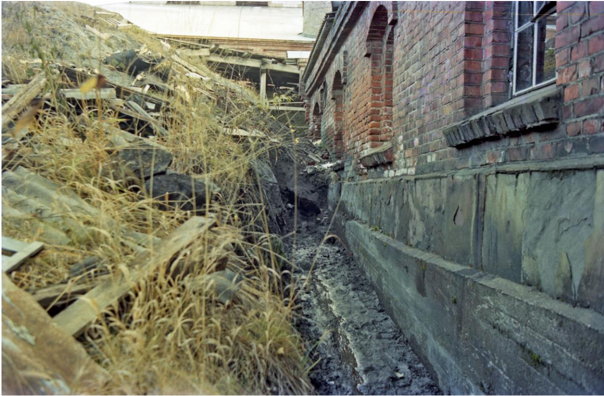
Figur 73: Dreneringsarbeider ved nordveggen på Fyrhuset ca. 1989. Som vi ser er det svært fuktig Er det fukten man har villet hindre med tidligere betongpåstøp?
