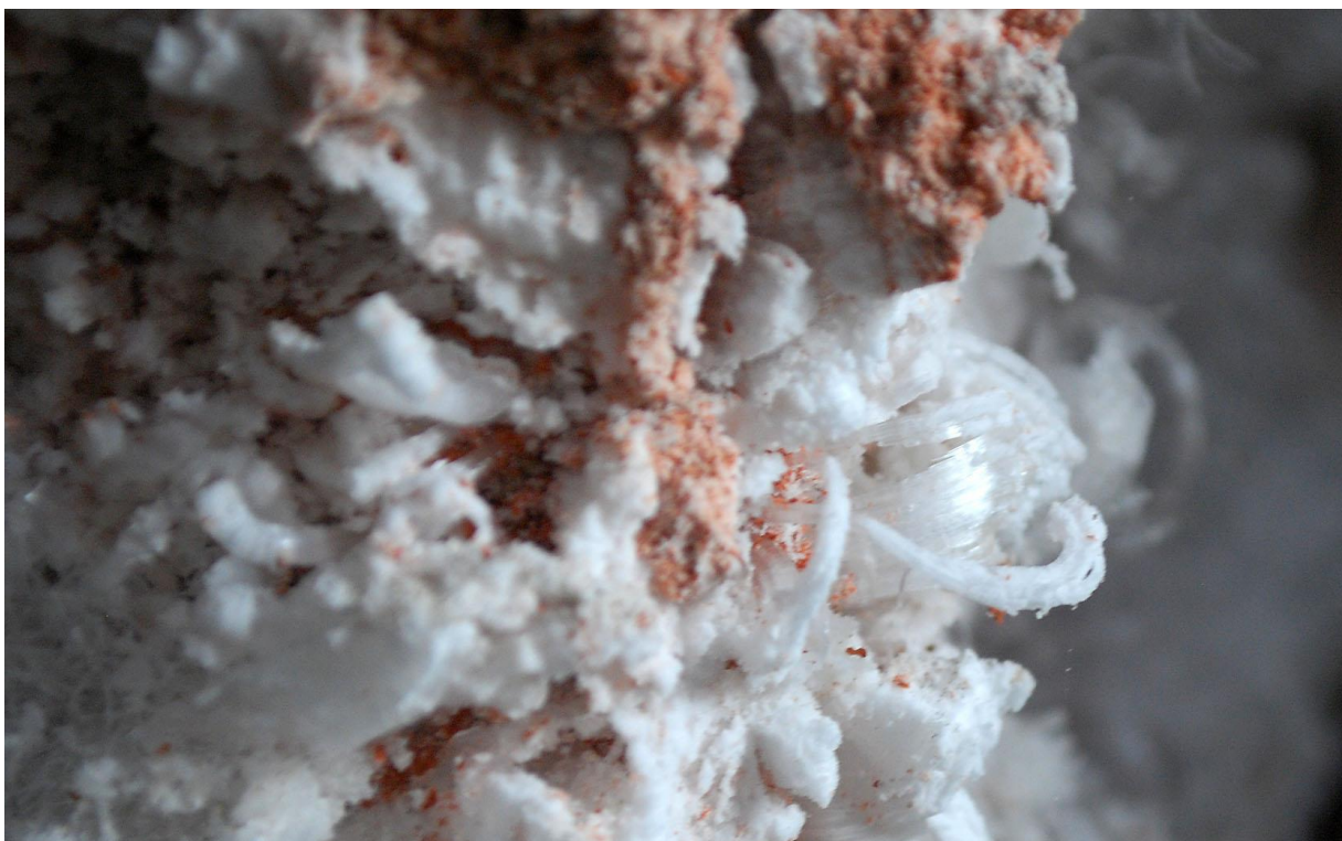
Figur 29: Kraftige saltwhiskers med flere cm størrelse «blomstrer» ut fra murverket i kjelleren til Luthuset og sprenger løs materialene.
