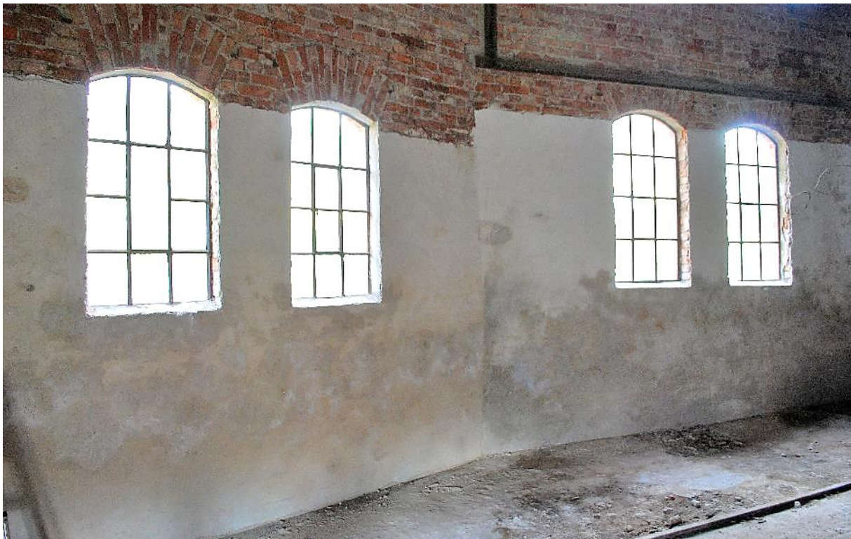
Figur 110: Store felter med kalkbasert offerpuss satt opp i Sodahuset i august 2021 med tydelige tegn til oppadstigende fukt og saltutslag. Når saltutslagene kommer i og på pussen er den virksom som offerpuss. Til venstre: Ferdigblandet Målarkalk (1:3). Til høyre: Egenprodusert hotmix (med Franzefoss brent kalk i pulver).
