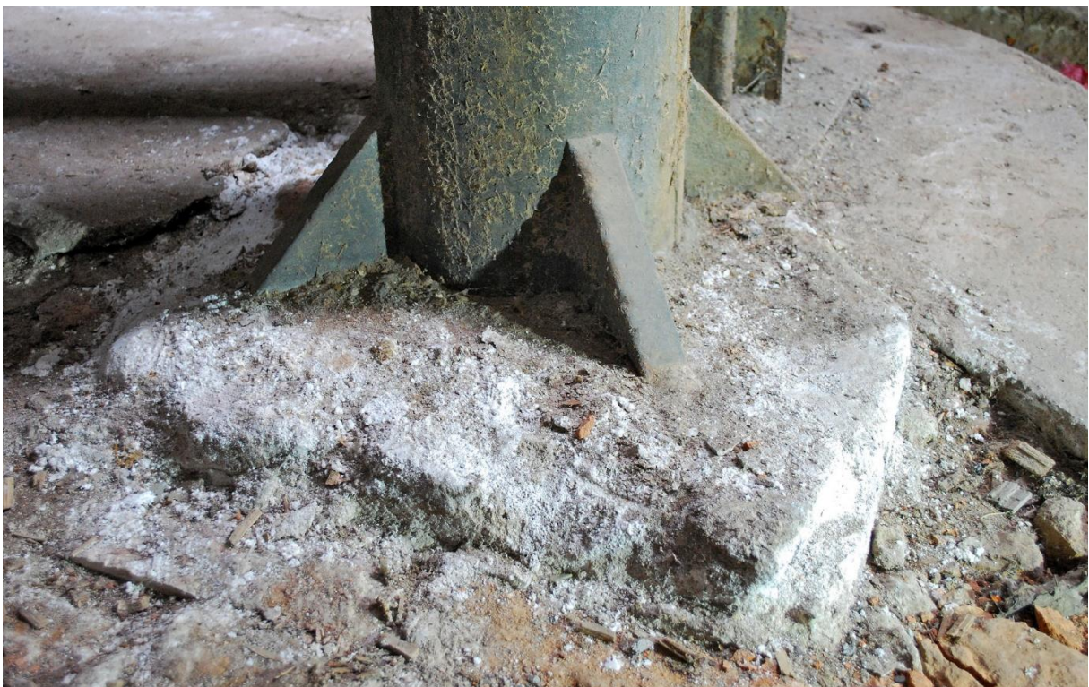
Figur 48: Søylefundament i Kokeriet, sterkt skadd av salt. Det er benyttet en betongforsterkning her, og en kan mistenke betongen for ikke å være av god kvalitet. Dette gjelder også flere steder i fabrikkens der relativt ny betong er benyttet som forsterkning.
