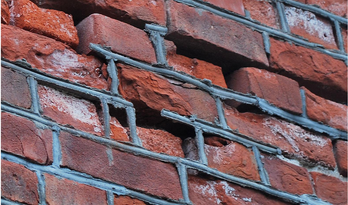
Figur 50: Fyrhuspipa er på spesifikke steder utendørs preget av forvitring. Her er det dyp forvitring av enkelte stein og de harde og tette pølsefugene av sterkt sementholdig mørtel står igjen. Det er åpenbart fukt som driver forvitringen og at salt er viktig. I tørre perioder er det mye mer salt her enn på bildet. Men frost kan nok også spille en rolle.
