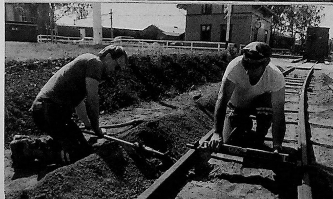
Finn Halling og Vidar Skilnand justerer spor 1 i Sørum- sand. Etter at sporet er jekket opp i riktig høyde, er det klart for pakking.
