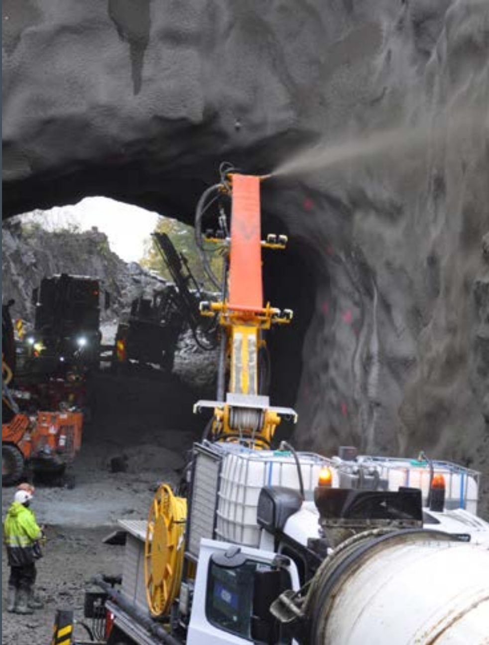
Sprøytebetong under påføring ved rehabilitering av Rustantunnelen på fv. 40 i Numedal, Nore og Uvdal kommune 2019. (Foto: Kjell Wold)
