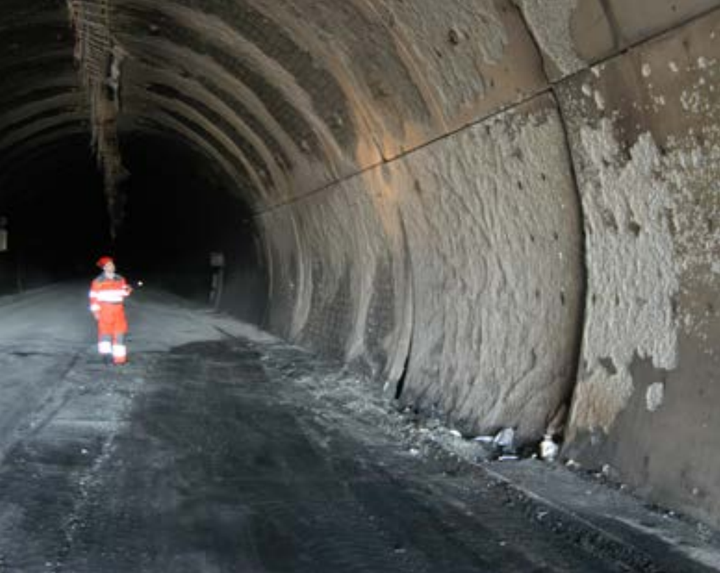
Sprøytebetong kan være bedre for brannsikring enn betongelementer. 17 vegg-elementer og 40 takelementer ble såpass ødelagt at de måtte skiftes ut etter at en lastebil med plastbelagt papir brant opp i Follotunnelen på E6 i Akershus 10. mai 2009. Reparasjonen tok to uker og kom på nærmere 20 millioner kroner. (Foto: Håkon Aurlien)
