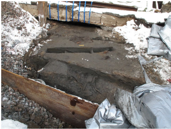
Figur 9 Området etter at sikringsarbeidet er ferdigstilt 28. februar 2011. Stålplata ses i forgrunnen. Bildet er tatt fra Schweigaardsgate mot Bussterminalen i nord. Foto NMM.
