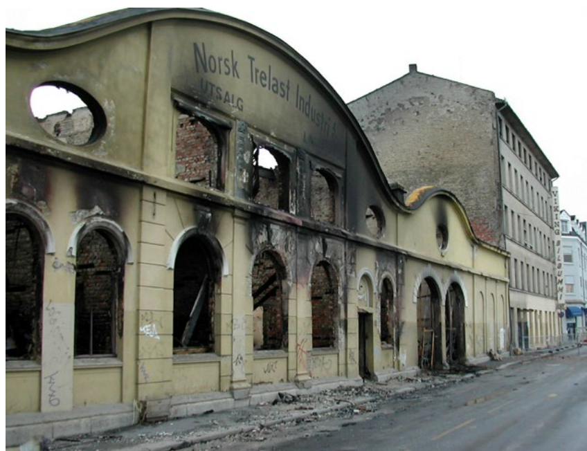
Ved brann og etterfølgende skade i det fredete Trelastlageret i Schweigaards gate 28 i Oslo krevde Riksantikvaren gjenreisning av en eksakt kopi av den fredete fasaden. (Foto: Riksantikvaren)
