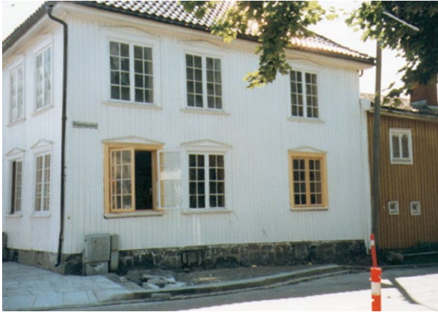
Fredet bygning i Tønsberg. Utskifting av vinduer var i strid med fredningsvedtaket. (Foto: Vestfold fylkeskommune)
