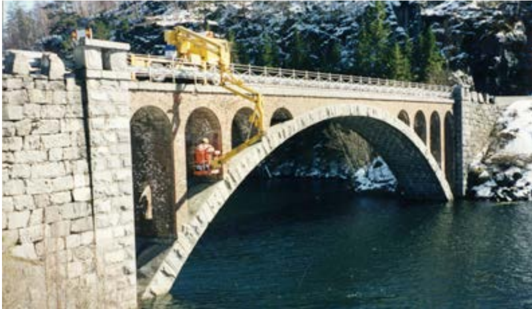
Ved rehabiliteringen i 2012 var det et mål å redusere fuktgjennomgangen i bruene. Natursteinsbuene ble påført belegg som hindrer vanngjennomtrengning og stopper dermed videre utfelling av kalk, som kan sees som hvite belegg på konstruksjonen (Foto: Per Austnes)
