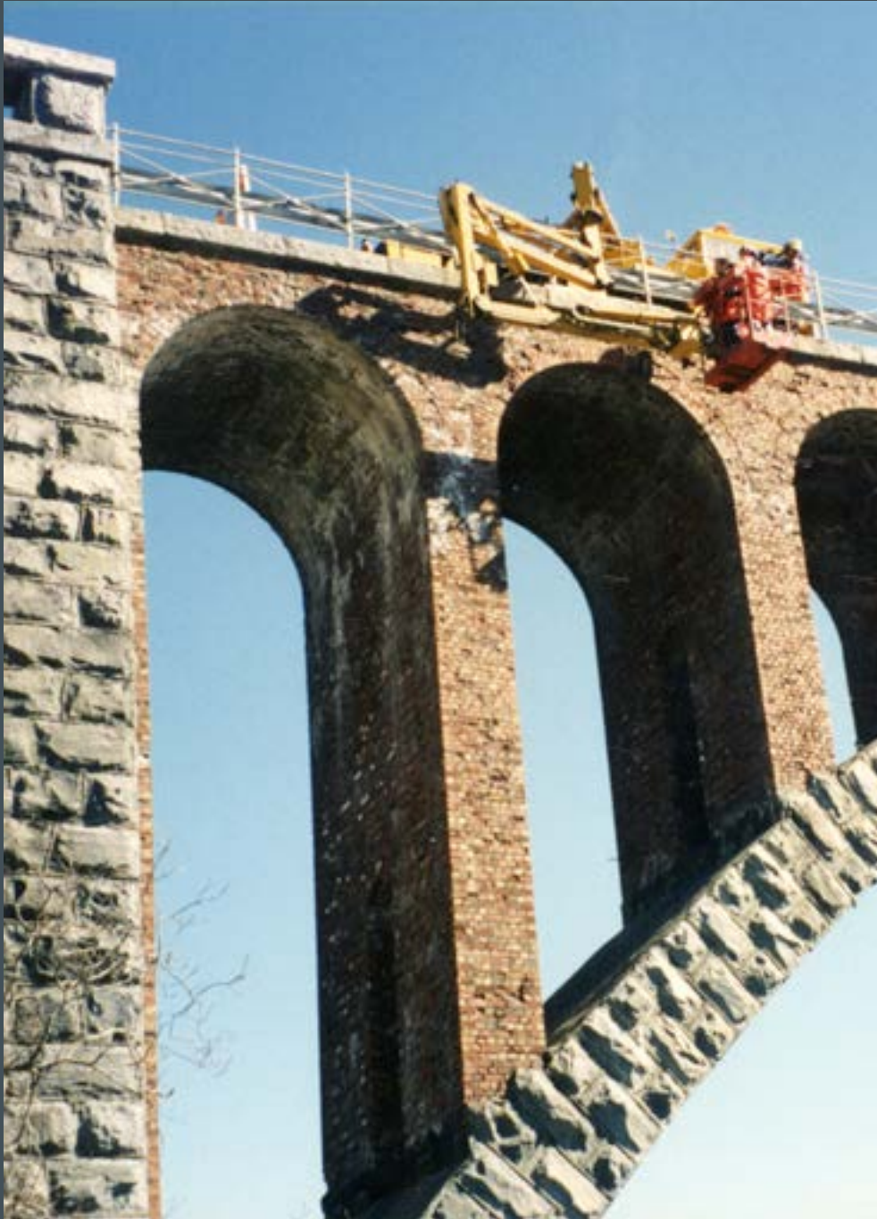
Detaljerte undersøkelser var et nødvendig grunnlag før rehabilitering av de flotte Skodjebruene i Møre og Romsdal ble iverksatt i 2012. (Foto: Per Austnes)
