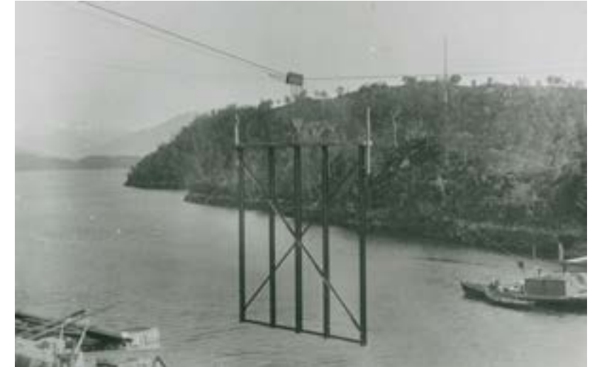
Byggingen av Skodjebruene innebar mange praktiske utfordringer, blant annet hvordan man kunne frakte materialer på en effektiv måte. Et tiltak var etablering av en kabelbane som ble flittig brukt i hele anleggsperioden. (Foto fra Vegidirektorens Meddelelser).
